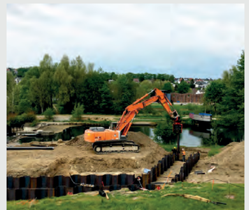
Wasserkraftanlage Schwitten | Fröndenberg
