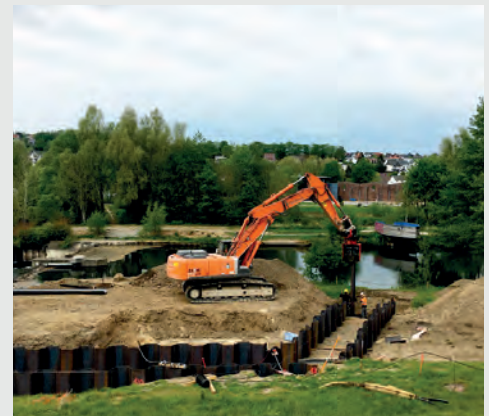
Wasserkraftanlage Schwitten | Fröndenberg
