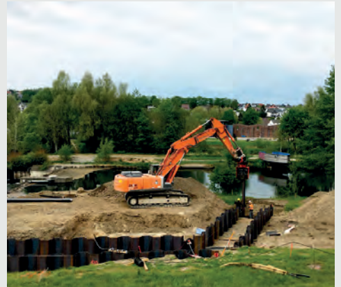
Wasserkraftanlage Schwitten | Fröndenberg
