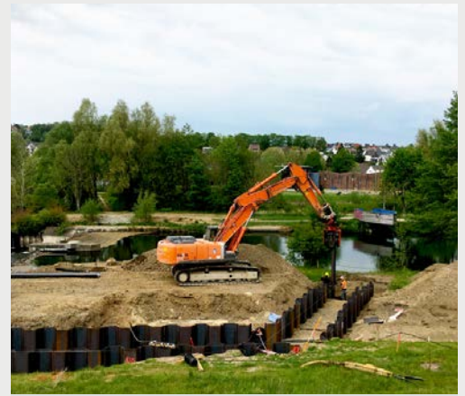
Wasserkraftanlage Schwitten | Fröndenberg
