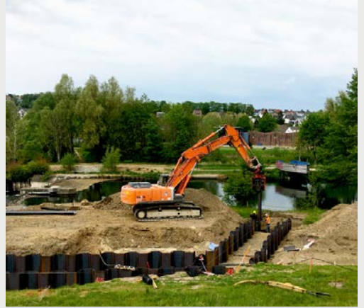
Wasserkraftanlage Schwitten | Fröndenberg
