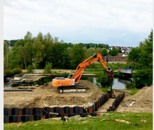
Wasserkraftanlage Schwitten | Fröndenberg
