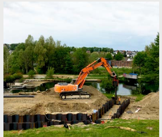
Wasserkraftanlage Schwitten | Fröndenberg
