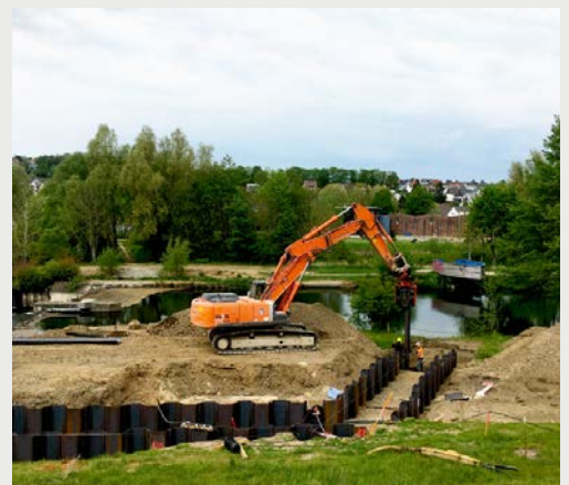
Wasserkraftanlage Schwitten | Fröndenberg
