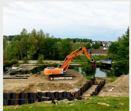
Wasserkraftanlage Schwitten | Fröndenberg
